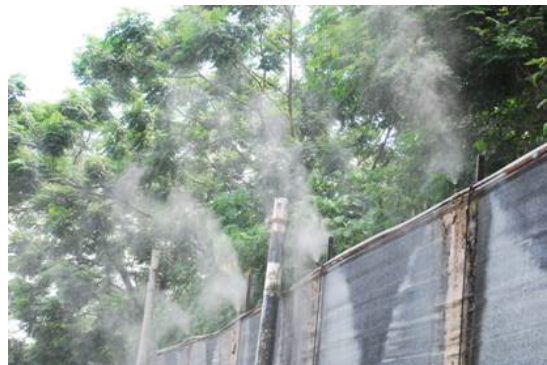
◎周界噴霧除臭設備
