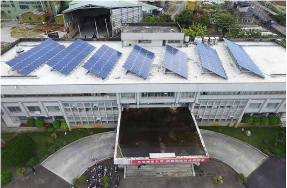
◎虎尾糖廠辦公室陽台上的太陽能發電組
