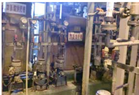
◎岡山垃圾焚化廠廢水處理設備景象
