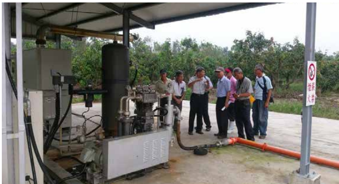
◎養豬場內的沼氣發電設備
