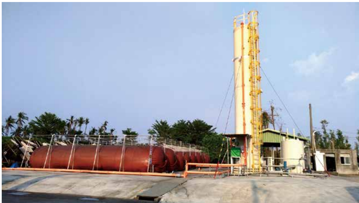
目前的沼氣發電設備
