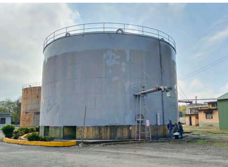
糖廠終端蜜儲存槽
