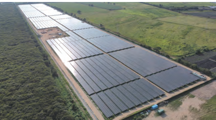
太陽能發電系統
