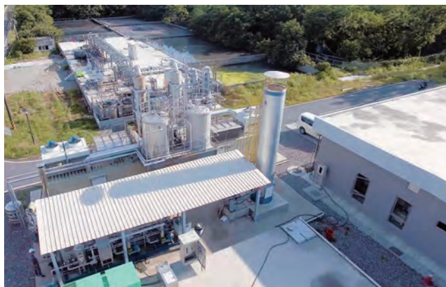
沼氣發電系統
