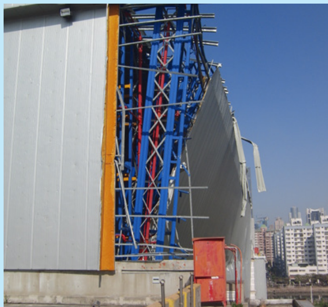
統倉外牆南側毀損側面照（修繕前）
