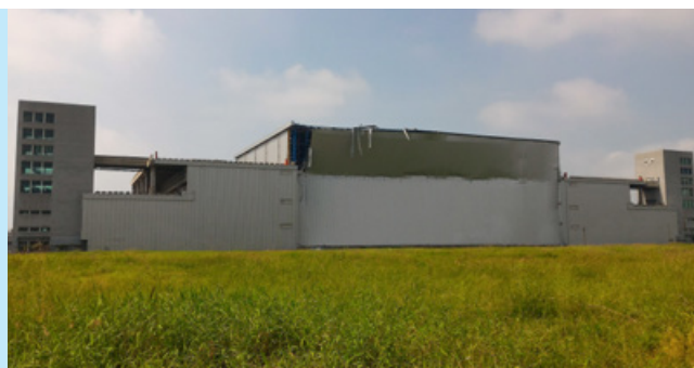
統倉外牆毀損全景照（修繕前）
