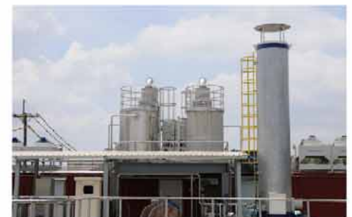
沼氣發電系統
