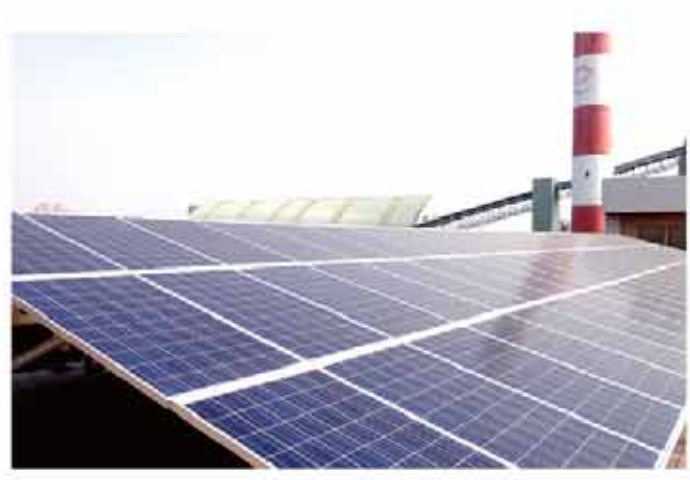
廠區屋頂之太陽能板設置
