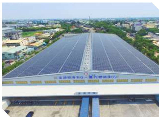
屋頂型太陽光電（溪湖物流園區）
